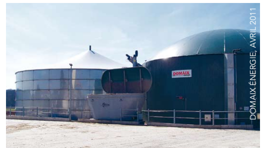
L'unité de méthanisation du Gaec de Grivée est la plus importante de Champagne-Ardenne: elle produit une quantité d'électricité correspondant à la consommation annuelle de 450 ménages.
